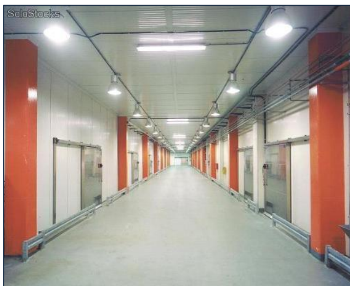
Figura 23. Instalaciones-eléctricas. Nota: imagen tomada de www.solostocks.com
