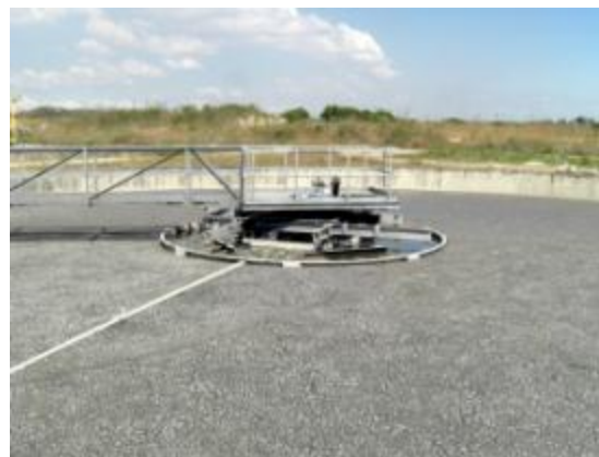
Figura 4.16. Reactor de la Planta la Mariposa II. Año 2010
