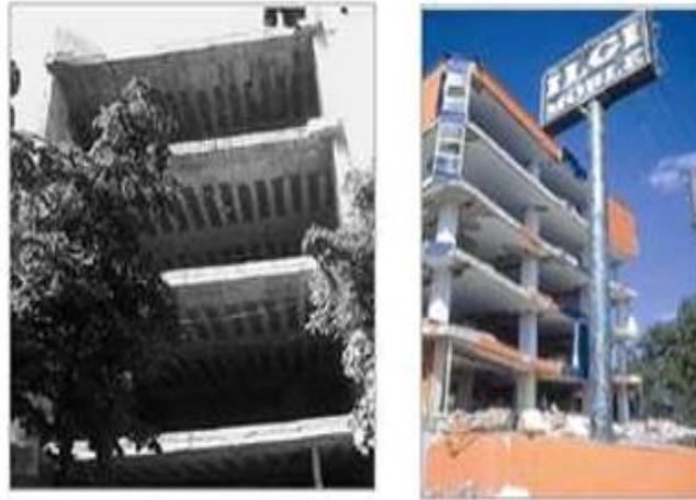
Ilustración 14: Ausencia de vigas.
