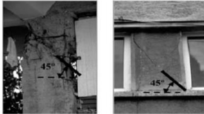
Ilustración 8: Falla Frágil, columna corta y poco esfuerzo transversal.
