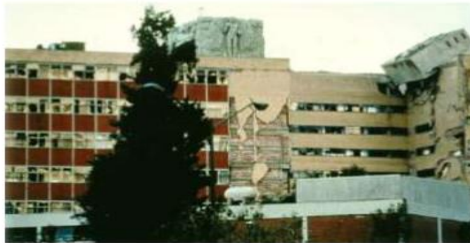
Ilustración 3: Colapso de tanques para agua en un hospital.
