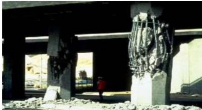
Ilustración 2: Falla de piso blando en columnas de grandes dimensiones.
