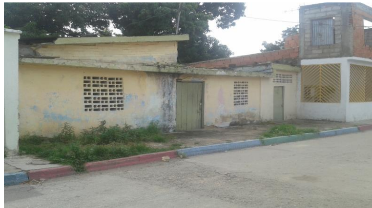
Ilustración 30: Edificación de mampostería de baja calidad calificada como "Muy Vulnerable".
