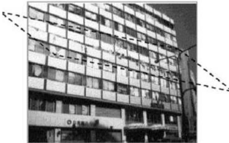
Ilustración 1: Colapso del Quinto piso (Débil)
