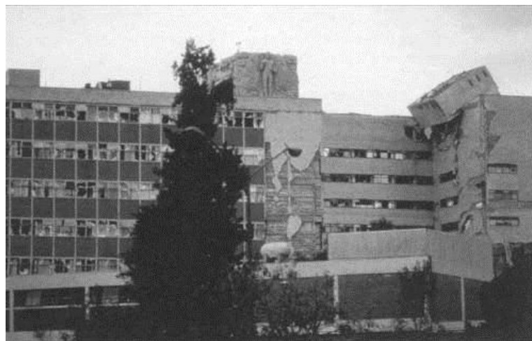
Figura II.7 Daños de un Hospital debido a problemas de configuración estructural.
