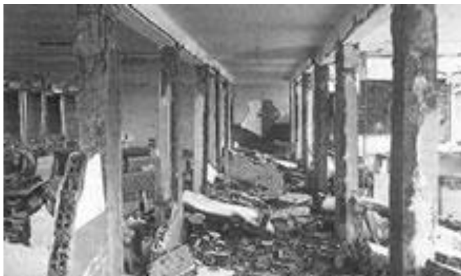
Figure II.6 Daños no estructurales por flexibilidad excesiva (Pereira, 1995)
