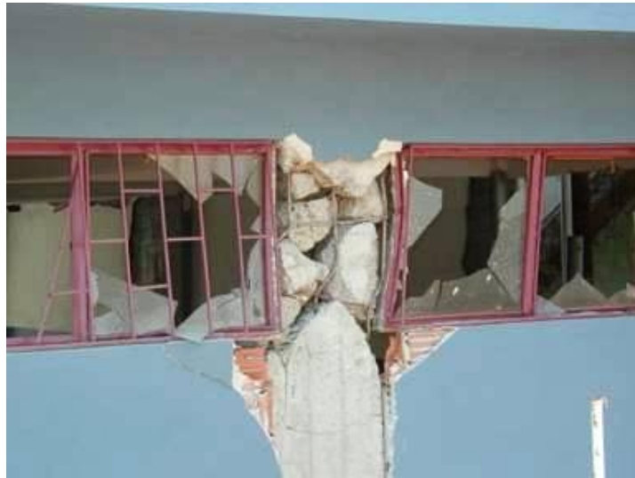
FIG. 2.17 FALLA DE UN PÓRTICO OCASIONADA POR EFECTO DE “COLUMNA CORTA” (TURQUÍA)
