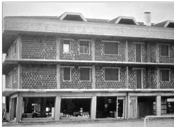
FIG. 2.10 FALLA EN EDIFICIO POR ENTREPISO BLANDO
