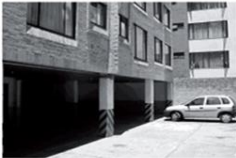
FIG. 2.11 LA SUSPENSIÓN DE LOS MUROS DEL PRIMER NIVEL PRODUCE UN PISO DÉBIL
