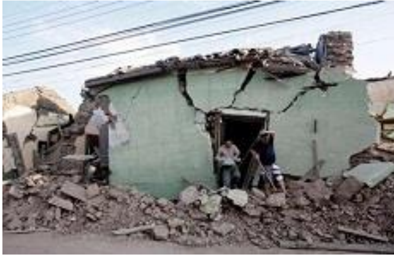
Figura 23: Mampostería no Confinada
