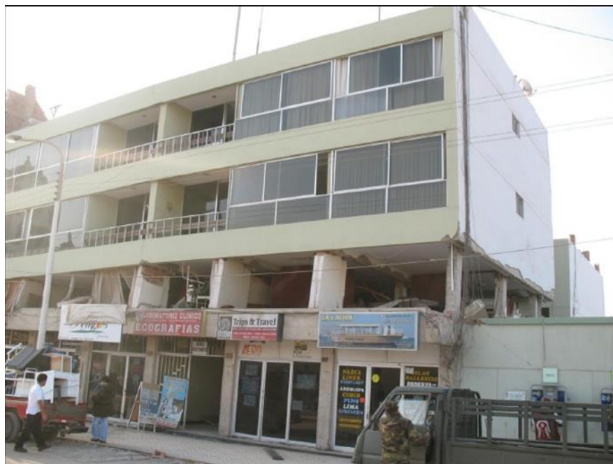
Figura 16: Entrepiso blando generado por proyecto con deficiencia estructural
