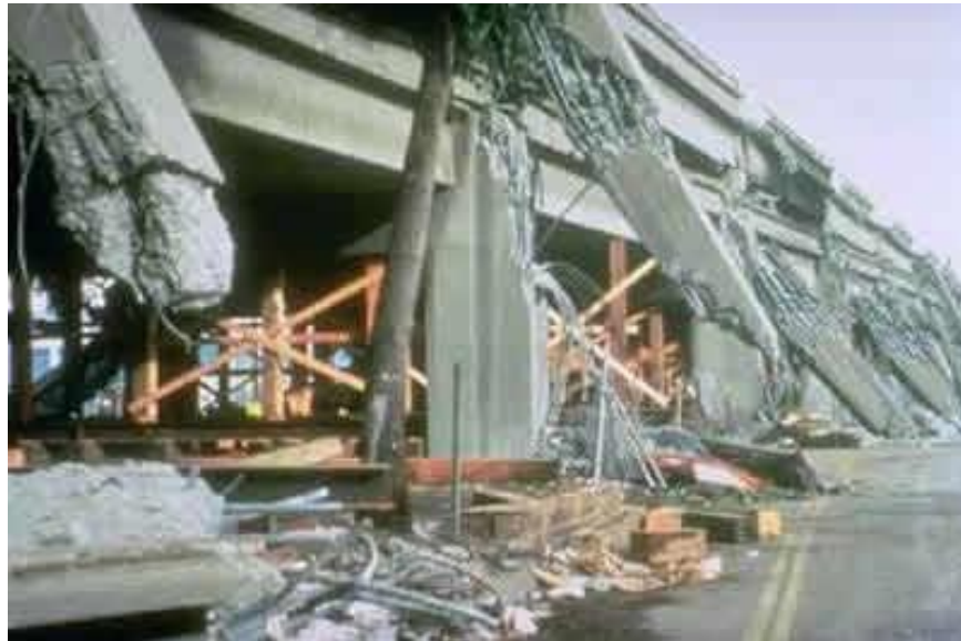
Figura 14: Daños en la estructura de un puente durante el Terremoto de Loma Prieta.
