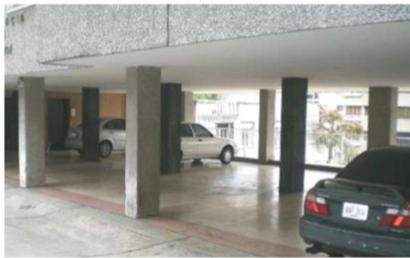
Figura 16. Ausencia de vigas altas en dos direcciones. Fuente: FUNVISIS, 2014
