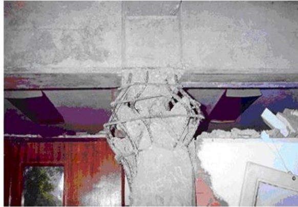
Figura 6. Fallas en columnas cortas del Edificio I, entrepiso 2 del liceo RMC durante el terremoto de Cariaco de 1.997.
