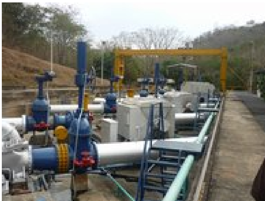
Figura 4.3. Sistema de bombeo de la presa
