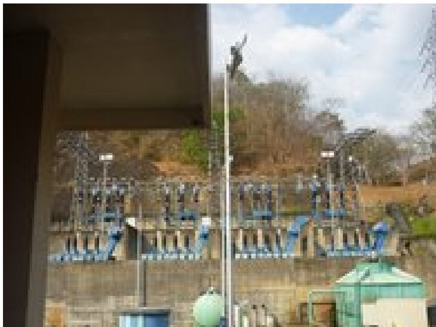
Figura 4.2. Sistema de generación eléctrica de la presa
