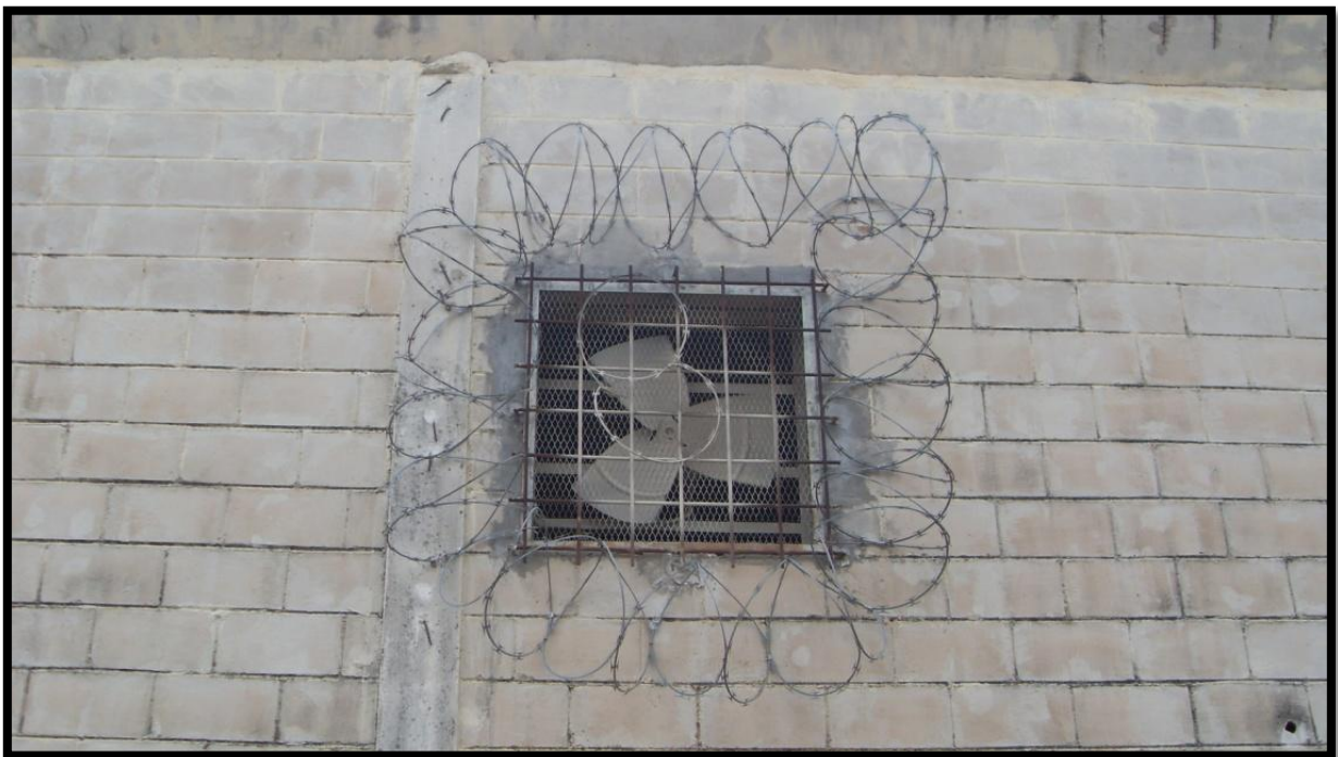
Figura 4.2 Extractor ubicado en la zona de mezclado en seco de IMMERC C.A.
