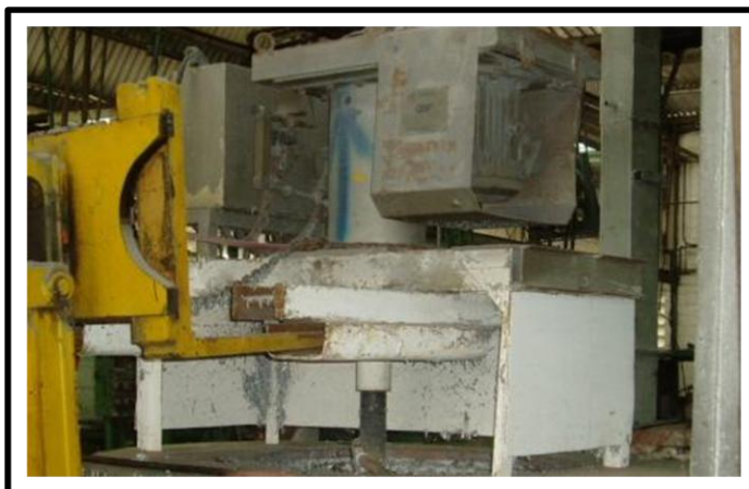
Figura 2.20. Motor de unidad desgasificadora.
