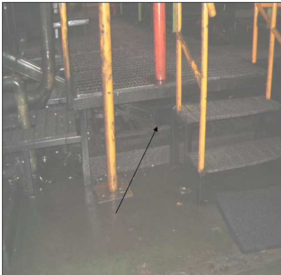
Figura N° 2. Entrada a la línea de producción, debajo de esta plataforma se encuentra la fosa recolectoras de lubricante. Fuente: Superenvases Envalic.
