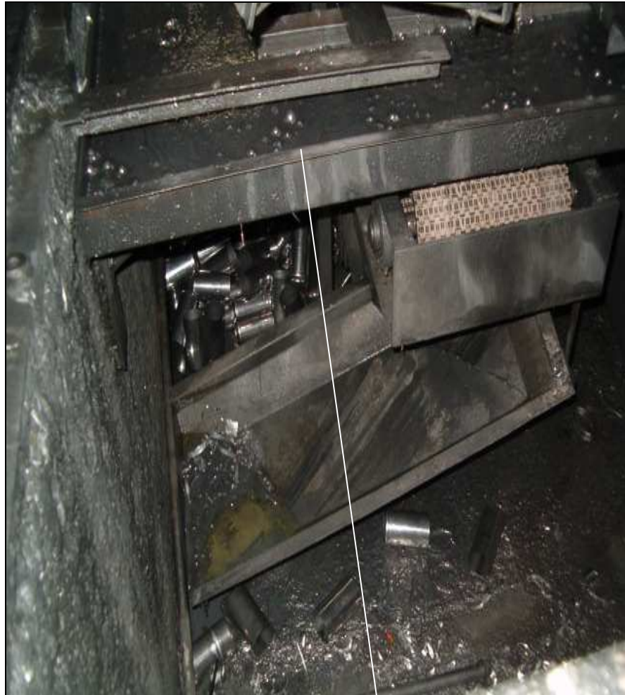
Figura N° 4. Fosa recolectora de aceite, zona sucia, de difícil acceso, contaminante y de riesgo.
