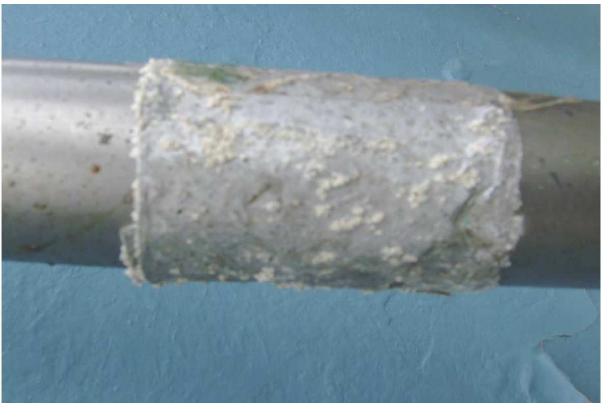
Figura 4.20 Cinta de aluminio con ampollas producto de la oxidación.
