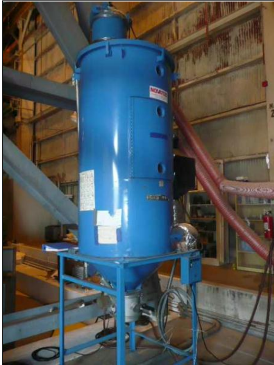
Figura 3.8. Secador / Enfriador (DC).
