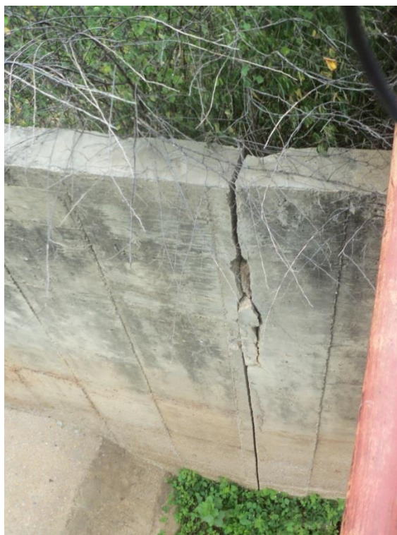
Anexo 38. Grieta en el embalse El Cigarrón.
