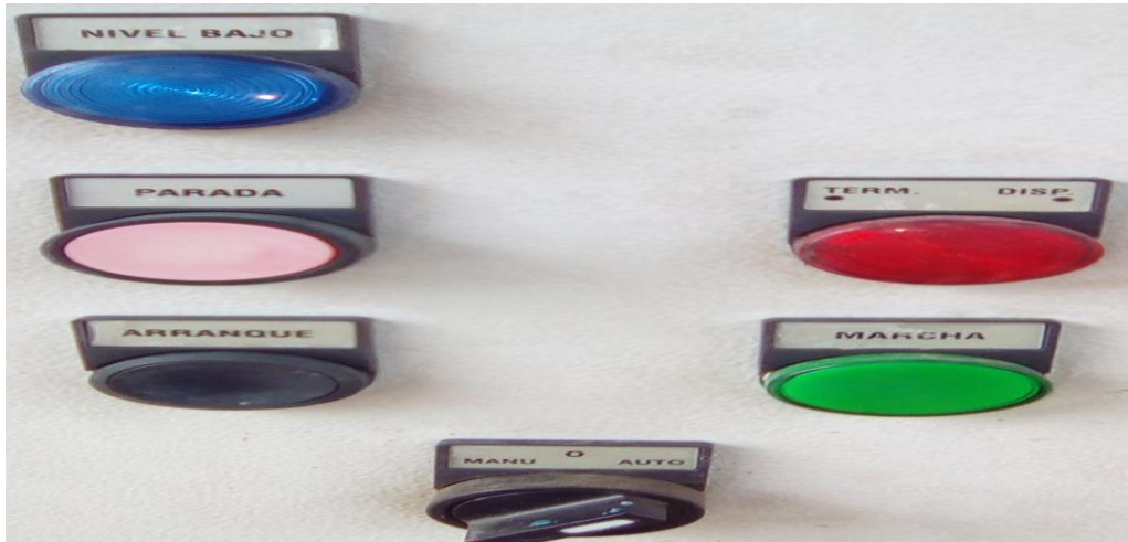
Figura 24. Encendido de la Bomba Mediante Sistema Automatizado Protinal Proagro Planta Embutidos UTM (614668 E; 1126507 N). Elevación: 444 msnm. Fecha: 10/04/2017 Zona Industrial, Municipio San Diego, Estado Carabobo
