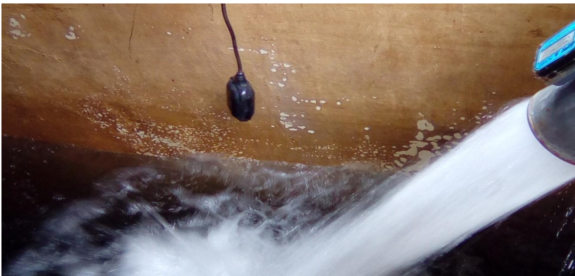
Figura 23. Encendido Manual de la Bomba mediante el Flotante Protinal Proagro Planta Embutidos UTM (614668 E; 1126507 N). Elevación: 444 msnm. Fecha: 07/04/2017 Zona Industrial, Municipio San Diego, Estado Carabobo
