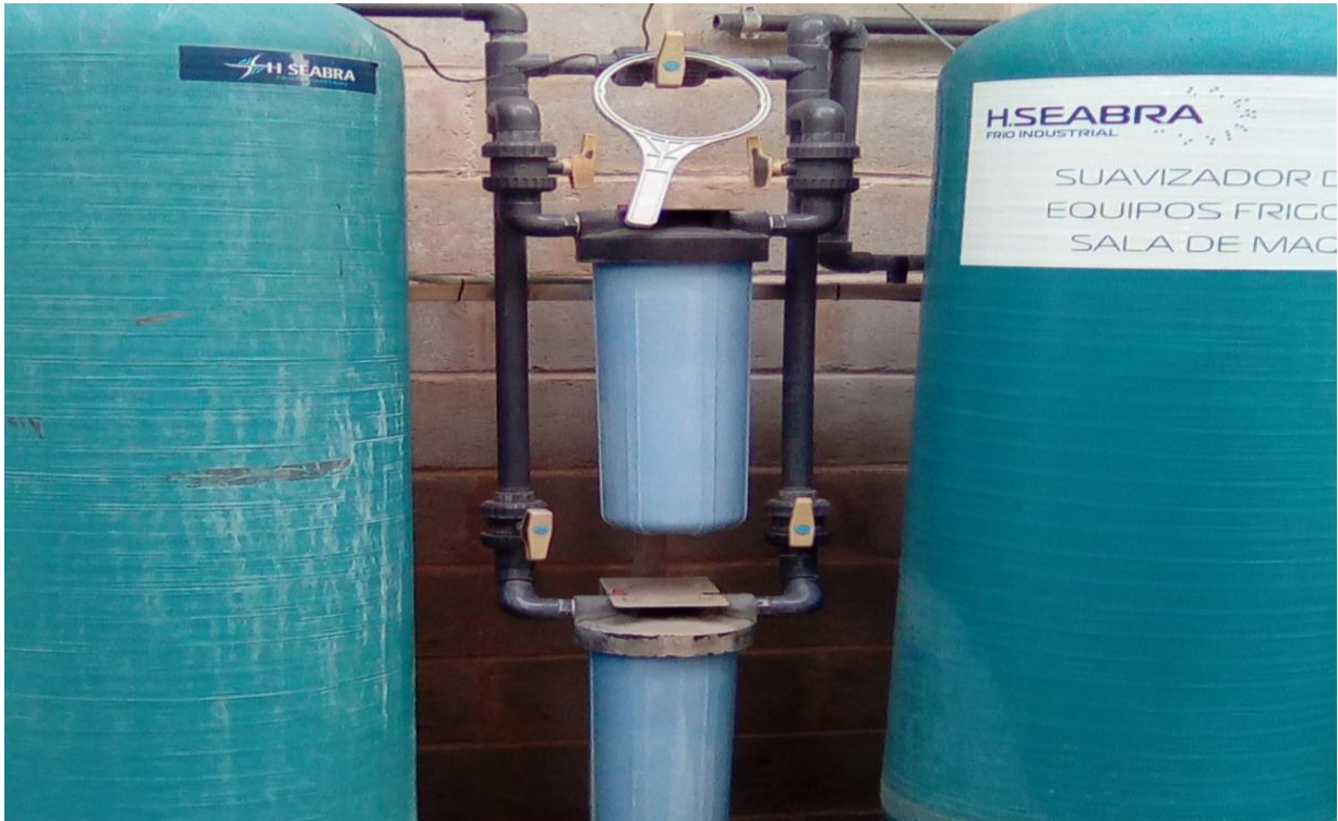
Figura 15. Equipo Suavizador de Agua Equipo Frigorífico Sala de Maquinas Protinal Proagro Planta Embutidos UTM (614668 E; 1126507 N). Elevación: 444 msnm. Zona Industrial, Municipio San Diego, Estado Carabobo
