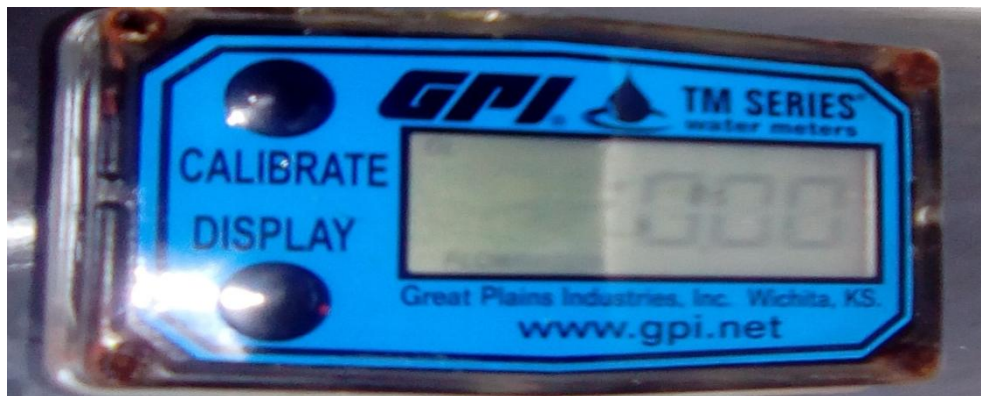
Figura 22. Medidor de Flujo de Agua Marca GPI Protinal Proagro Planta Embutidos UTM (614668 E; 1126507 N). Elevación: 444 msnm. Fecha: 07/04/2017 Zona Industrial, Municipio San Diego, Estado Carabobo
