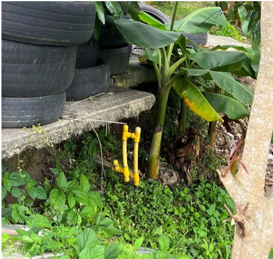
Exposición de tuberías de gas en la comunidad El Turpial
